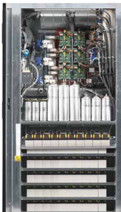
EQUIPAGGIAMENTO BATTERIE INTERNE
