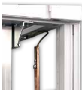
Barre di messa a terra
