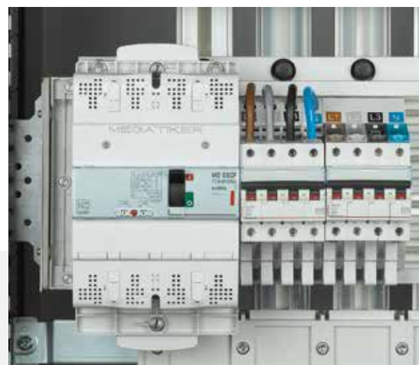
Montaggio affiancato ad interruttori modulari alimentati da sistema di ripartizione TIFAST EASY 125
