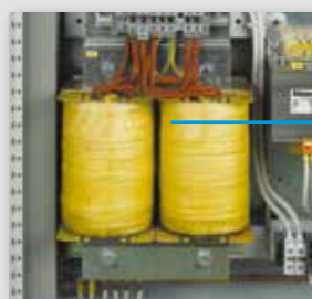
Trasformatore di isolamento
